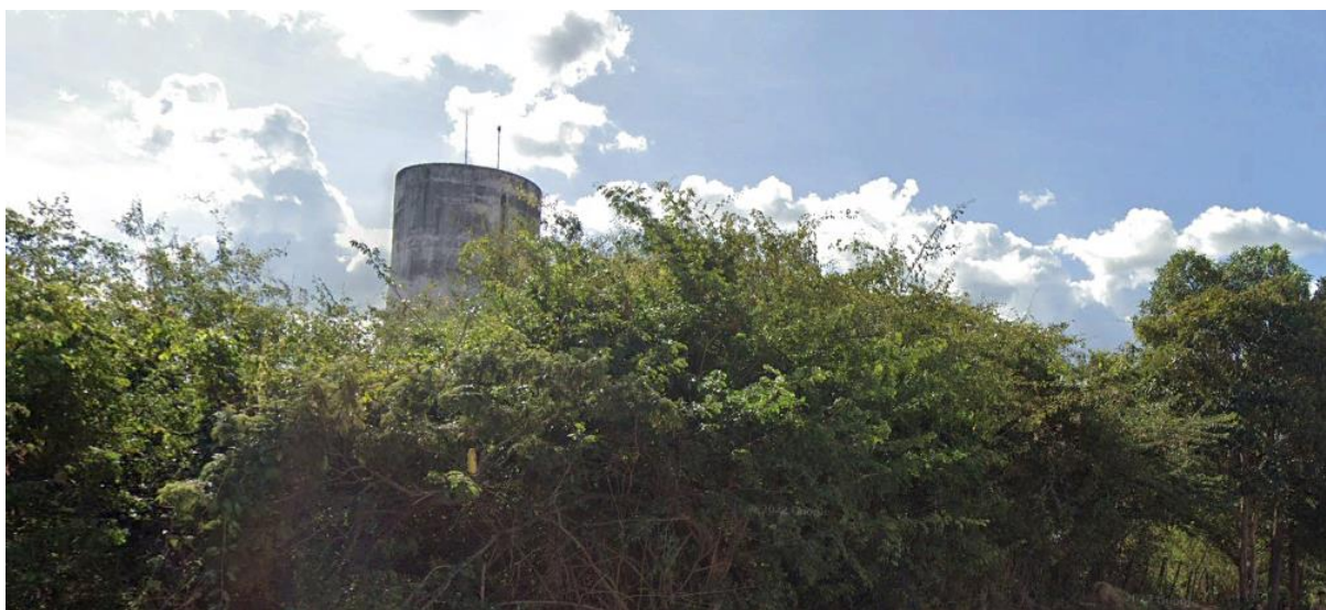
Figura 23. Sistema de reservação “Res-E”
