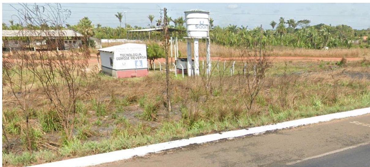
Figura 31. Poço e reservação na localidade Km-17
