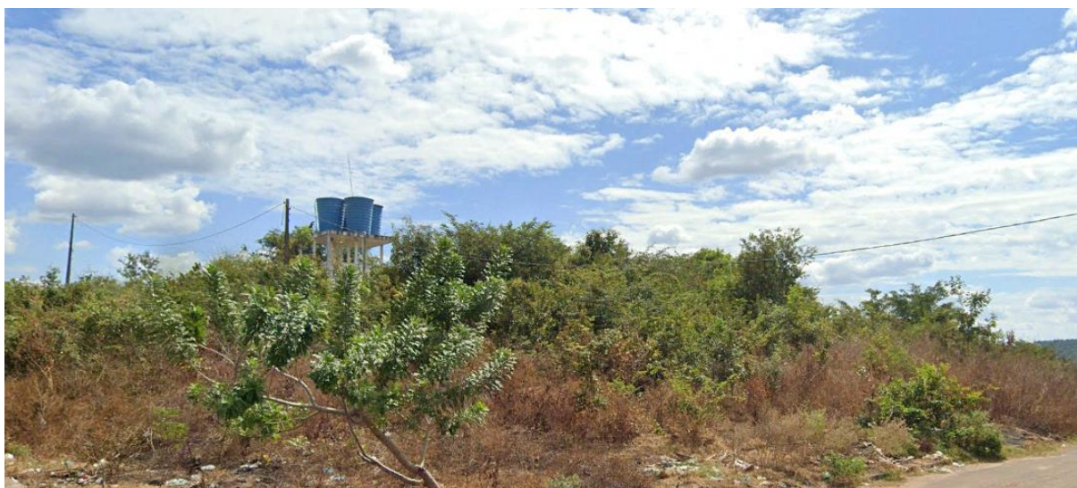
Figura 29. Sistema de reservação “Res-K”
