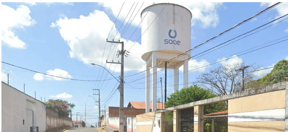
Figura 28. Sistema de reservação “Res-J”
