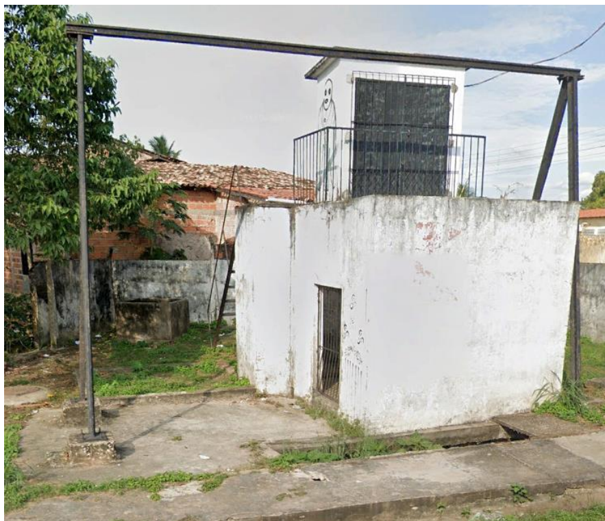
Figura 37. Estação elevatória de esgoto da Rua Coelho Neto
